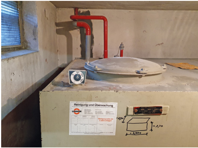
Stahltank für das Heizöl
